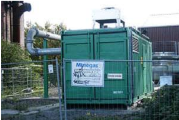
1 Stromerzeugung aus Minengas, Dortmund, früher Schacht „Minister Stein“ Power generator using black damp, Dortmund, former mine “Minister Stein”
